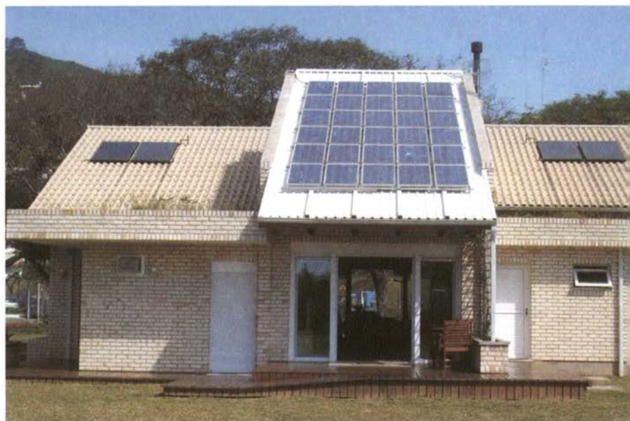
Módulos solares fotovoltaicos integrados à cobertura da Casa Eficiente - Eletrosul, em Florianópolis.
